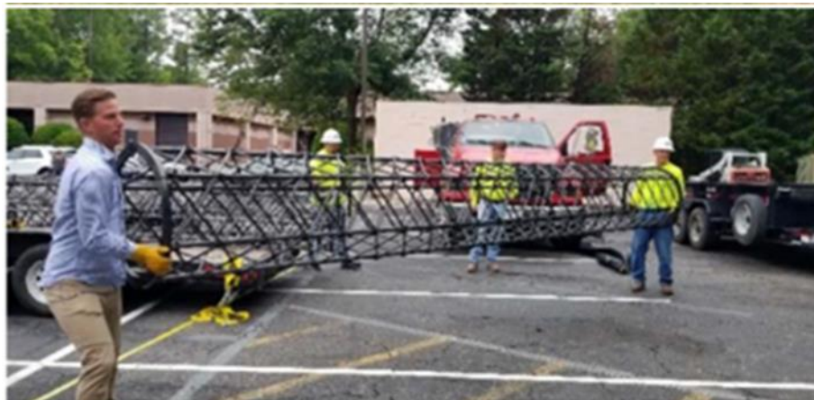
【IsoTruss 社の格子構造の軽量タワー（6m）】
