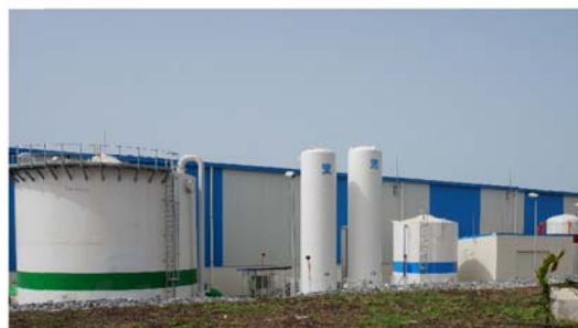
【海水淡水化プラント】
