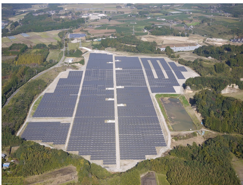
【球磨錦町太陽光発電所】
