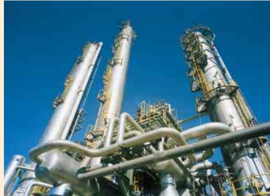
当社出資のインドネシア／メタノール製造会社 PT. KALTIM METHANOL INDUSTRI(KMI社)プラント
